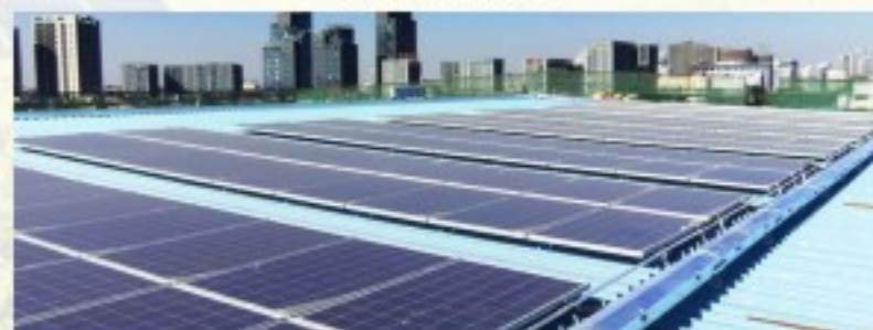
光伏发电项目
